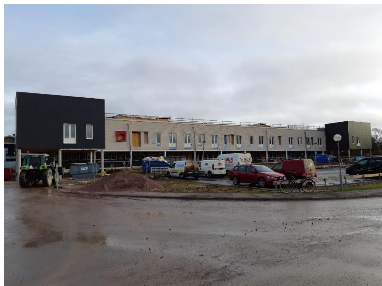
Ombyggnad av äldreboendet Mogården till trygghetsboende (foto under byggtiden år 2019), liknande projekt även genomfört i Fagerhult.
