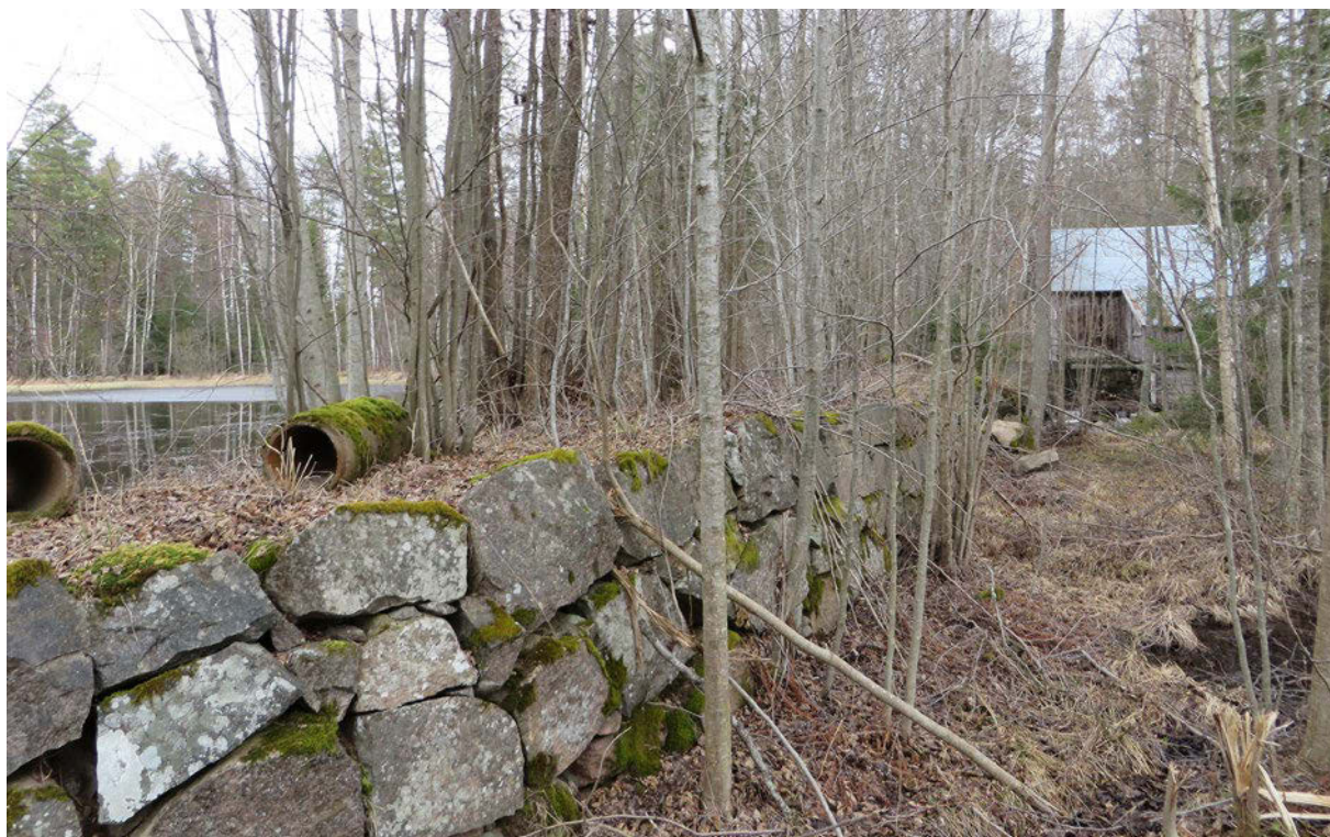
Sågens damm omgärdas delvis av stenlagda dammvallar, vilka bitvis rasat.
